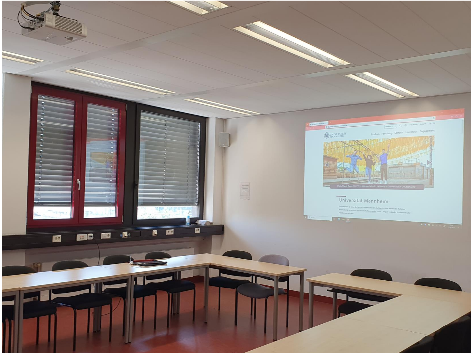
Raumansicht nach vorne. Links im Brüstungskanal das Bedien- und Anschlussfeld, sowie der Schalter für die Lautsprecher
