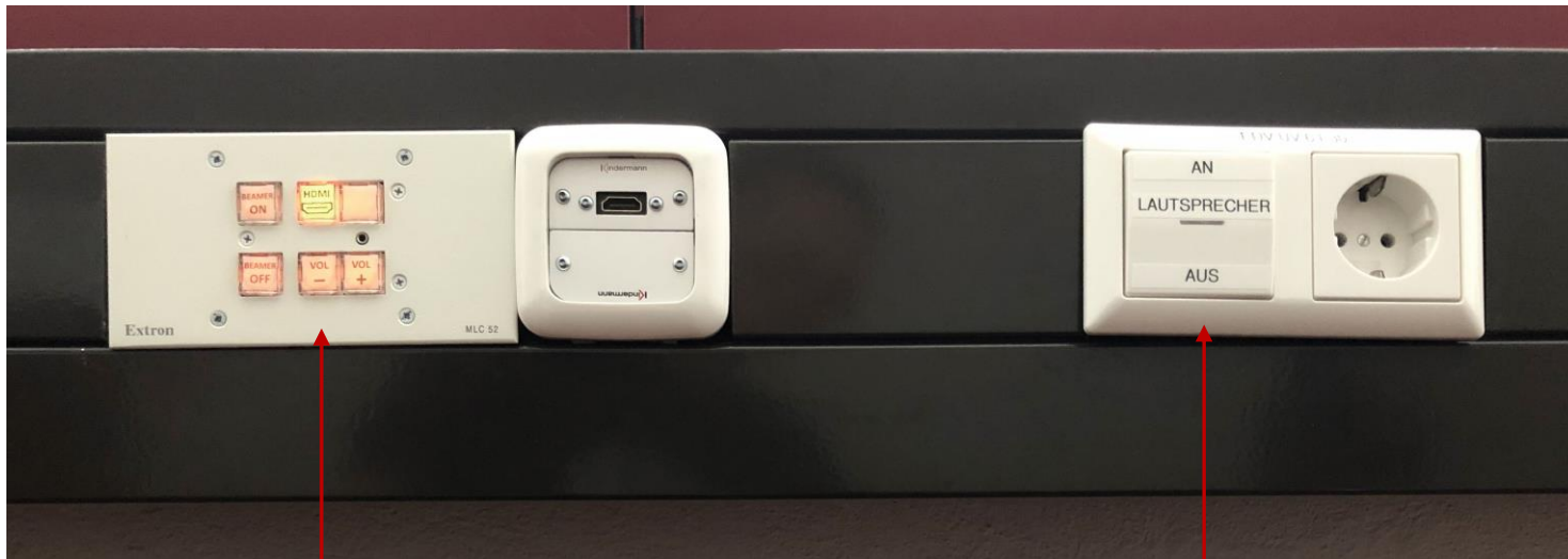
Anschluss- und Bedienfeld für den Projektor im vorderen Bereich der Fensterfront.
