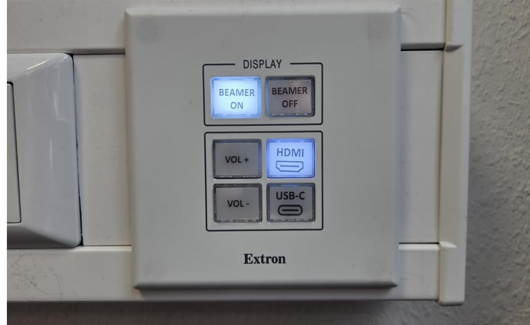
Bedienfeld im Brüstungskanal
