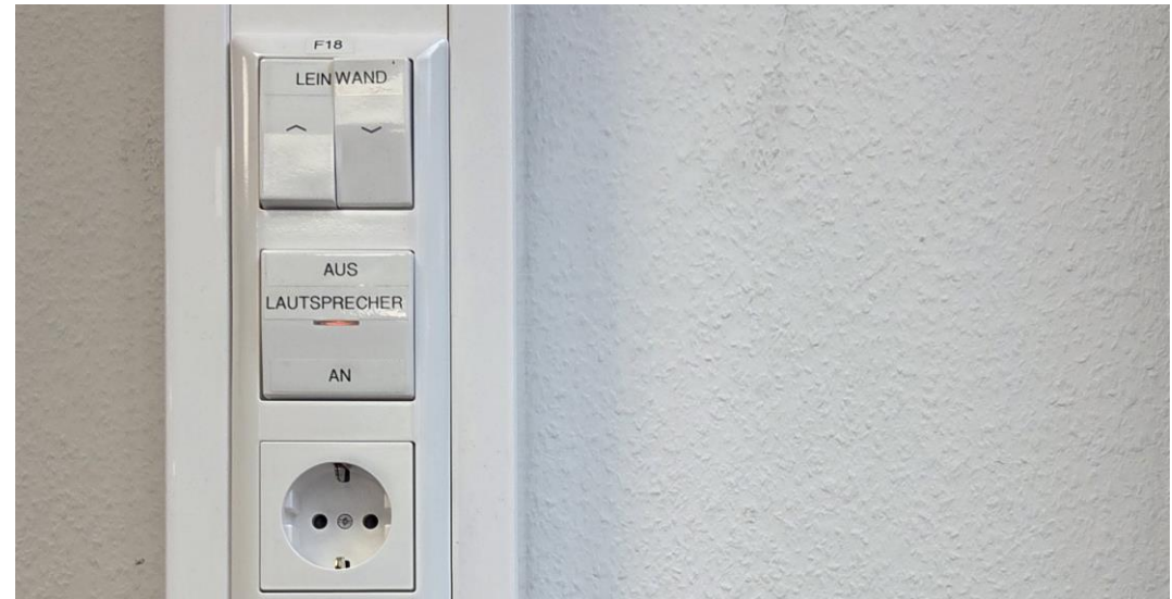
Schalter für Leinwand und Lautsprecher
