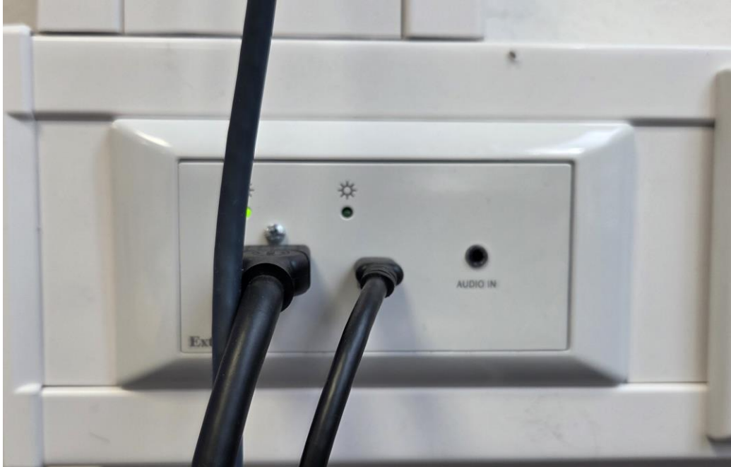
Anschlussfeld im Brüstungskanal
