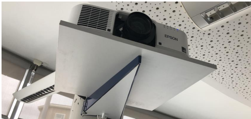
Leistungsstarker Beamer an der Säule
