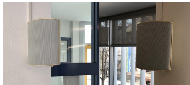
Lautsprecher neben dem Eingang 3 und an der Säule
