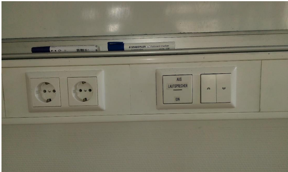
Leinwandsteuerung und Lautsprecher
