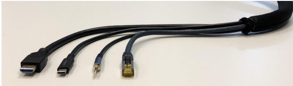
Vorhandene Anschlüsse auf dem Dozentenpult
