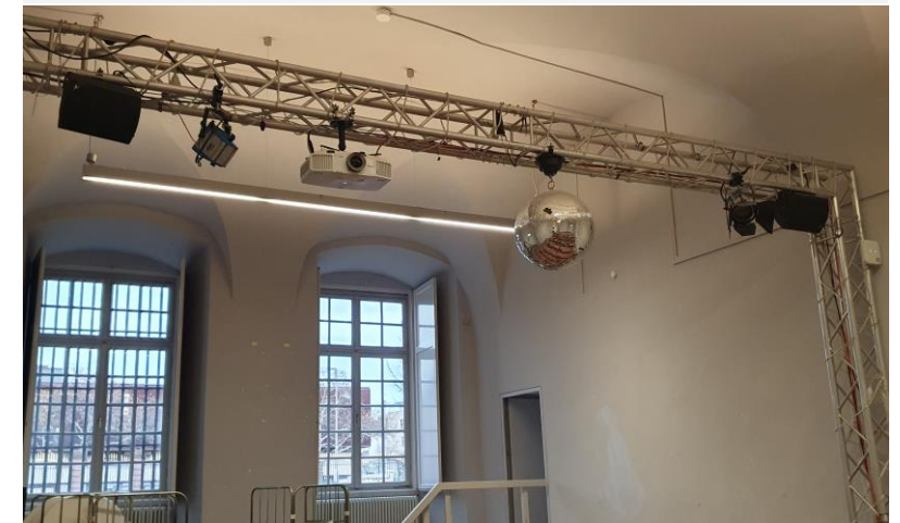
Ansicht nach hinten Traverse mit Beamer und Lautsprechern
