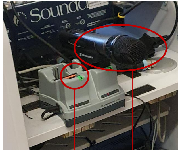
Ladestation mit Ersatzakku und Funkmikrofon rückseitig zum Mischpult im Audioschrank
